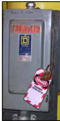
Figura vi-2: Bloqueo/Etiquetado del panel de fuente de alimentación
