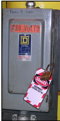
Figura SEGURIDAD-2: Ejemplo de un mecanismo de Bloqueo/Etiquetado en un panel de fuente de alimentación
