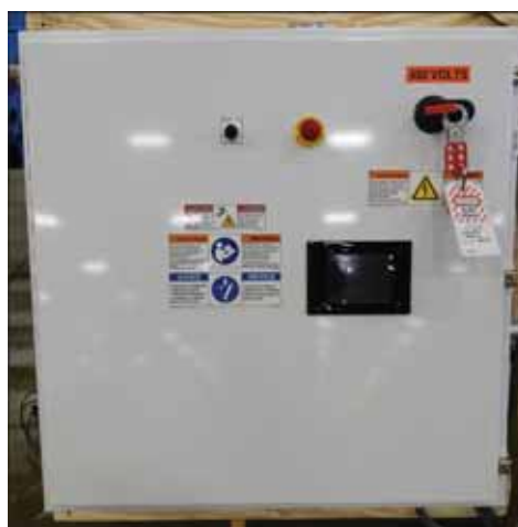
Figura 2-2: Ejemplo de un mecanismo de Bloqueo/Etiquetado en un gabinete eléctrico
