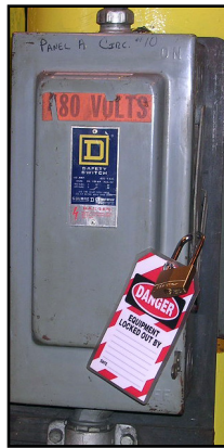
Figura 6-2: Bloqueo/Etiquetado del panel de fuente de alimentación
