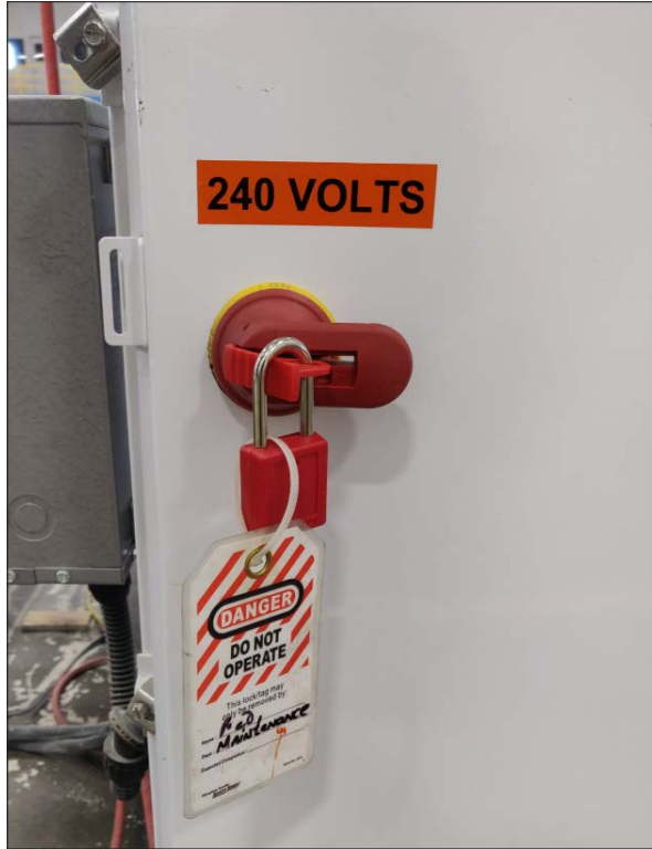
Figura 2-2: Mecanismo de bloqueo/etiquetado en un gabinete eléctrico principal
